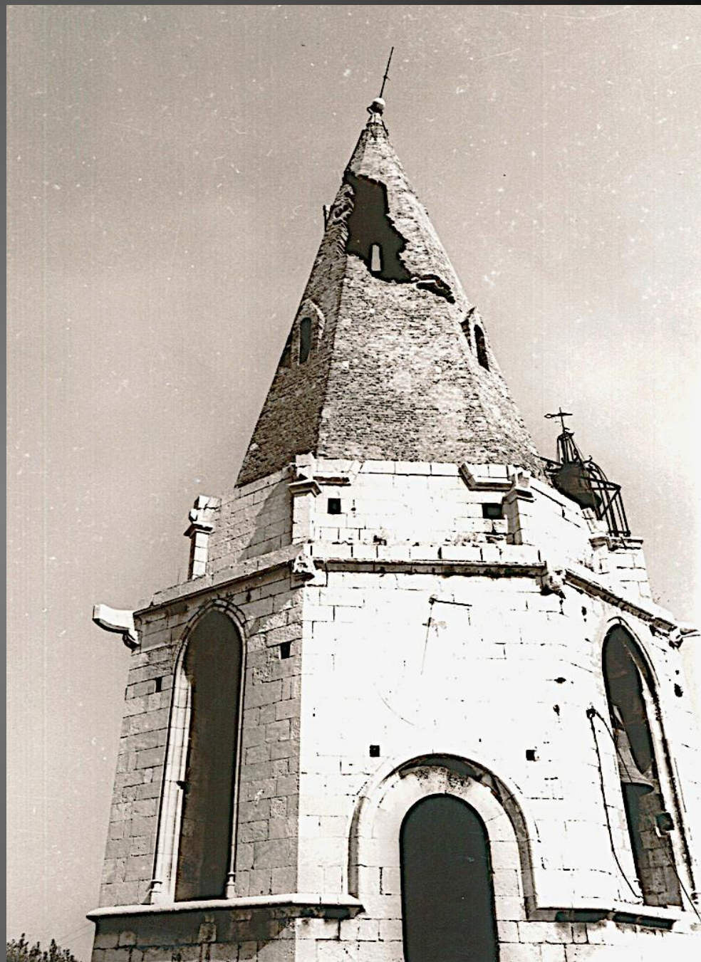
Le clocher endommagé par un orage. (Photos du web)
