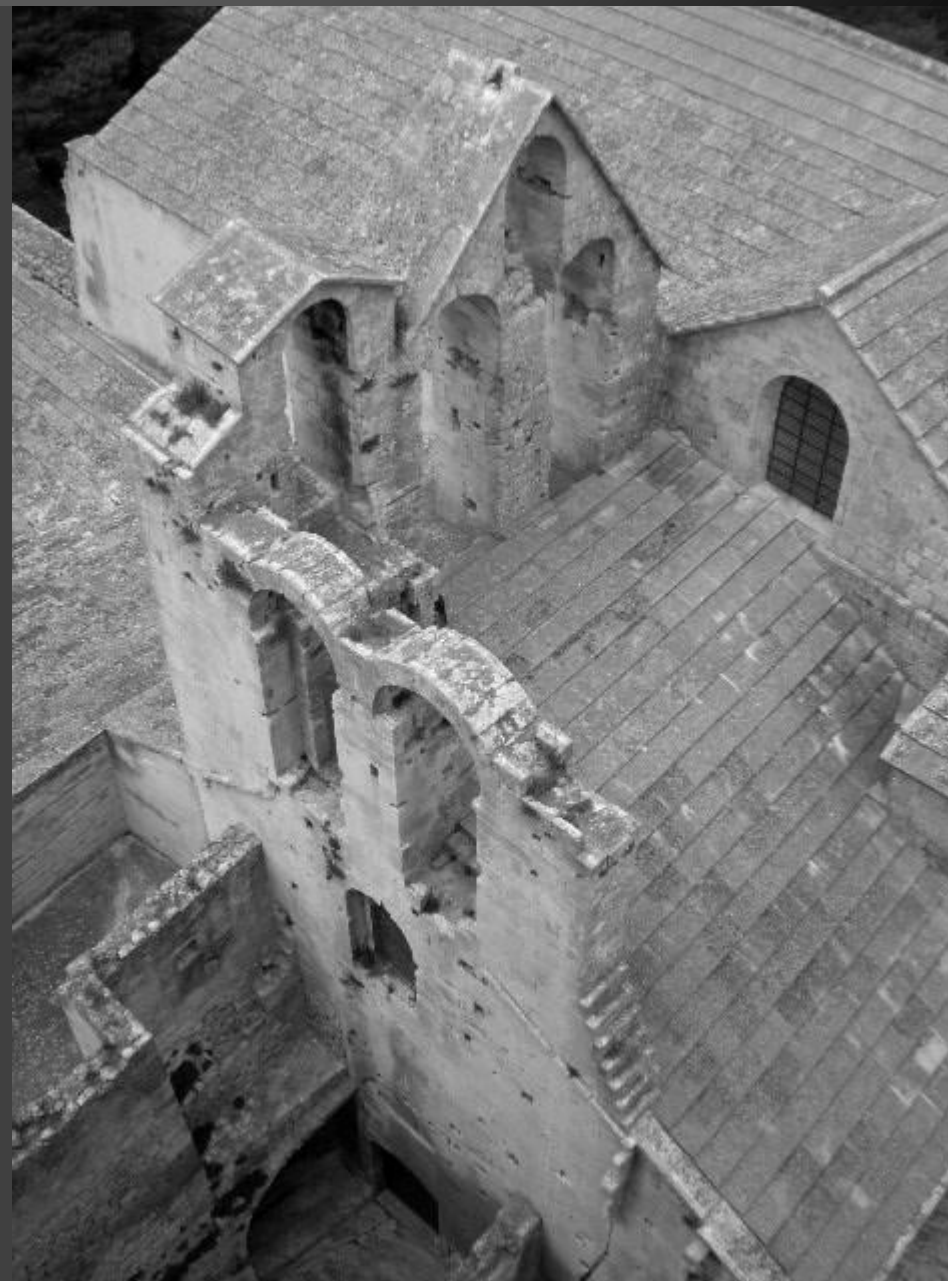
Toitures de l'abbatiale, vues depuis le sommet de la tour de Pons de l'Orme.
