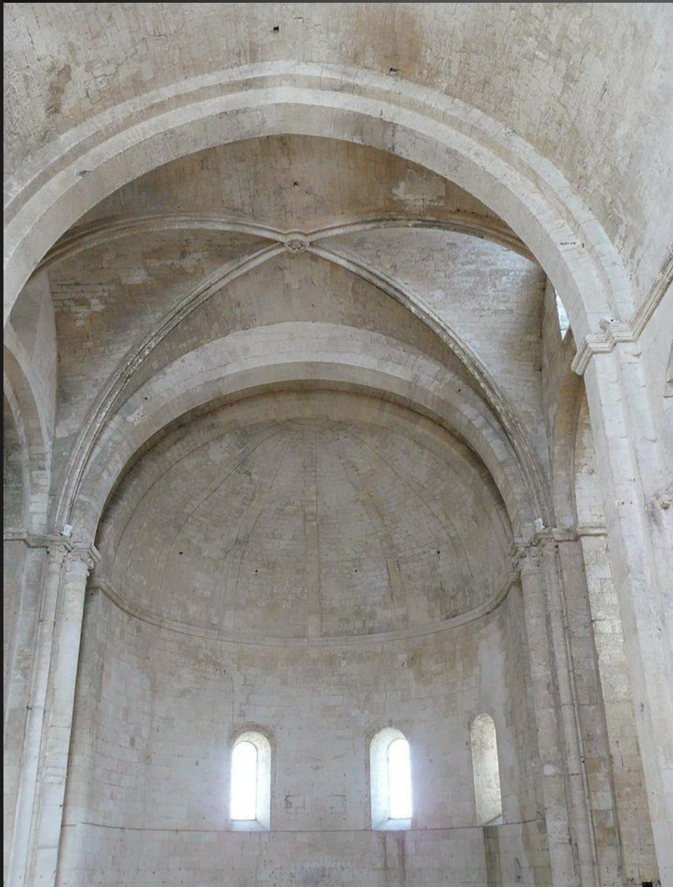
L'ÉGLISE HAUTE _ La vôte croisée du transept et la couverture en cul-de-four de l'abside, cette dernière est magnifiquement appareillée et sous-tendue par cinq nervures très plates issues du cordon de la naissance de la vôte et s'amortissant en demi-cercle contre le bandeau de la travée du chœur. ( Images du Web )
