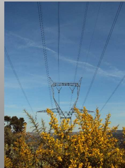
Une ligne à très haute tension passe désormais sur la colline.
